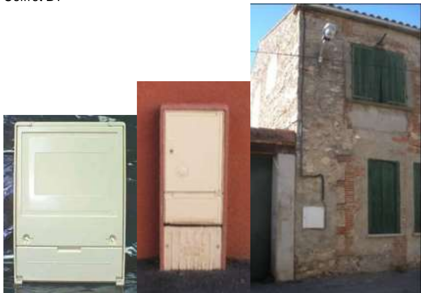
Poste de transformation compact
