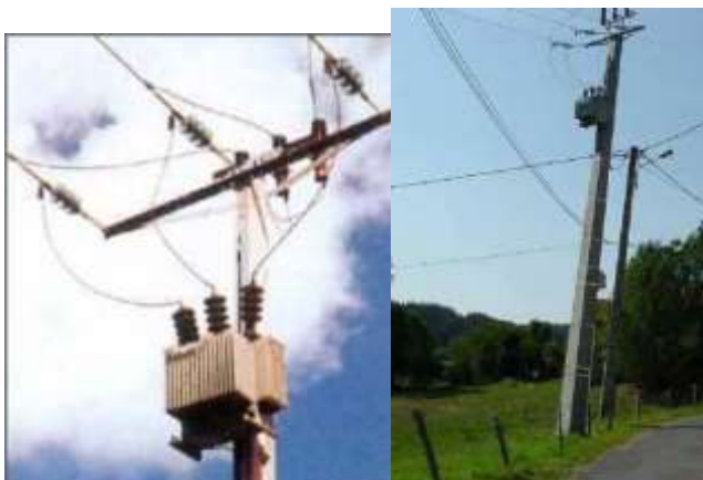
Poste de transformation sur poteau
