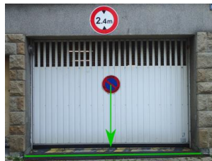
Seuil véhicule (ou seuil de garage) (© Brest métropole)
