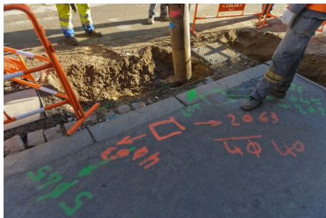
Medde - Arnaud Bouissou - Marquage au sol d'un réseau électrique et d'un réseau de télécommunication
