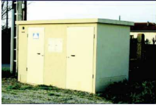
Poste de transformation enterré
