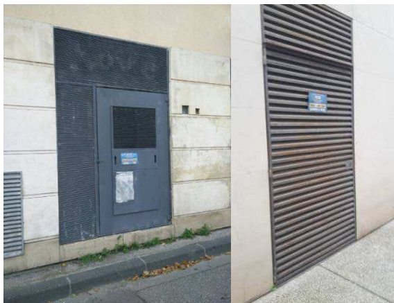
Poste de transformation en immeuble
