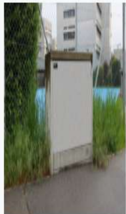
Petits boîtiers de distribution électrique
